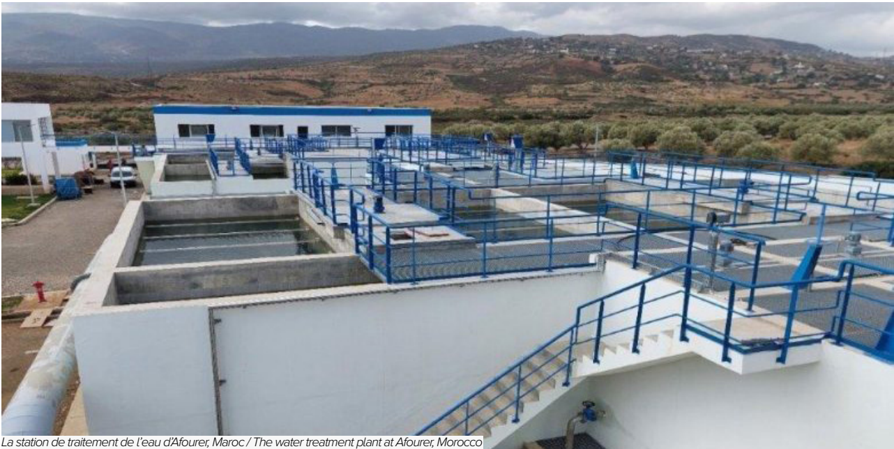
La station de traitement de l'eau d'Afourer, Maroc / The water treatment plant at Afouer, Morocco
