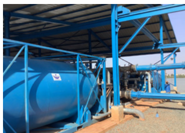
La station de pompage d'eau de Kalabambougou Kalabambougou water pumping plant
