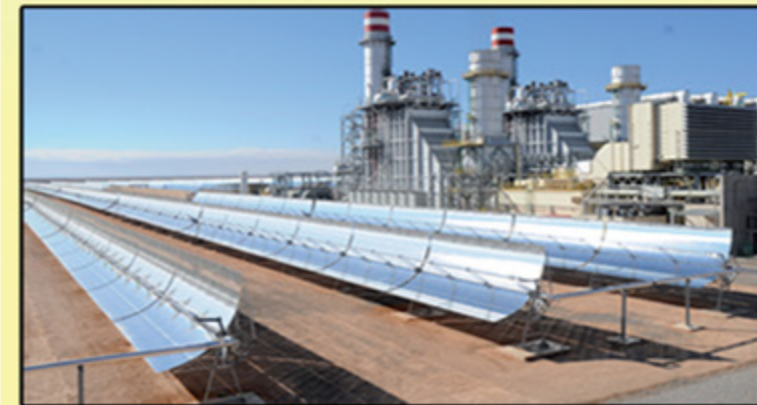
Centrale Thermo Solaire d'Ain Béni Mathar
