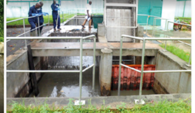
Gestion et canalisation des eaux usées
