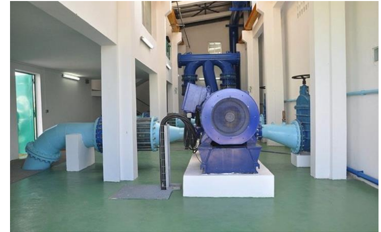
Station de traitement d'eau potable de Bonoua
