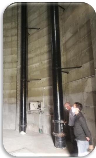
Conduites en acier carbone DN400 avec revêtement bitumé.
