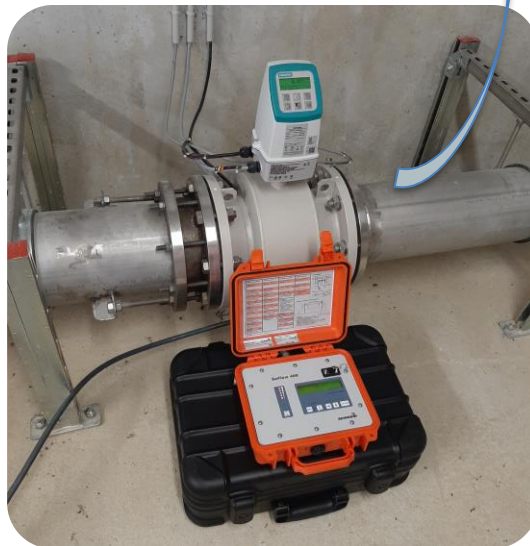
Comparaison DEM sur conduite en acier inox DN400.
