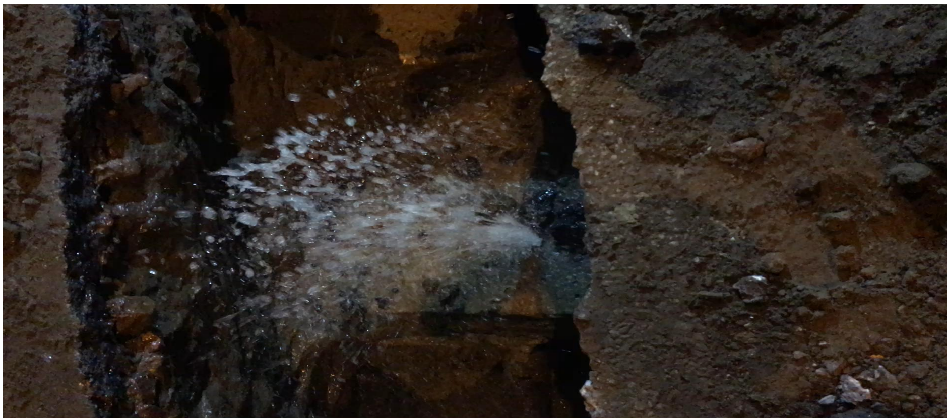
Fuite sur conduite fonte DN 100 dans un croisement avec le réseau d'assainissement
