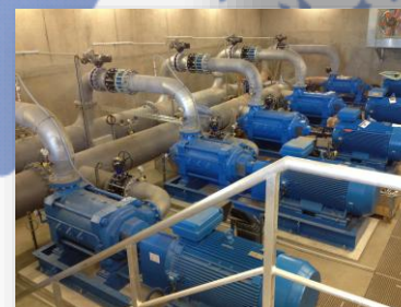
Interconnexion Bras de la Plaine et Bras de Cilaos, phase A, Ile de la Réunion
