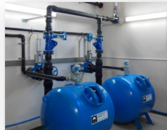
Poste de refoulement pneumatique, Louverné (53)
