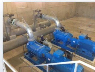
Transfert d'eau potable, Station Paradis, La Réunion
