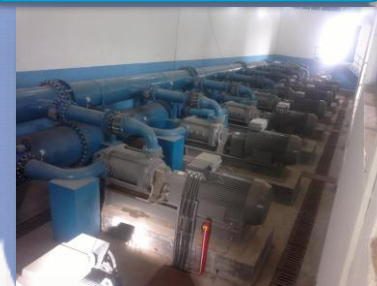
Station de pompage Akaki Phase II, Ethiopie
