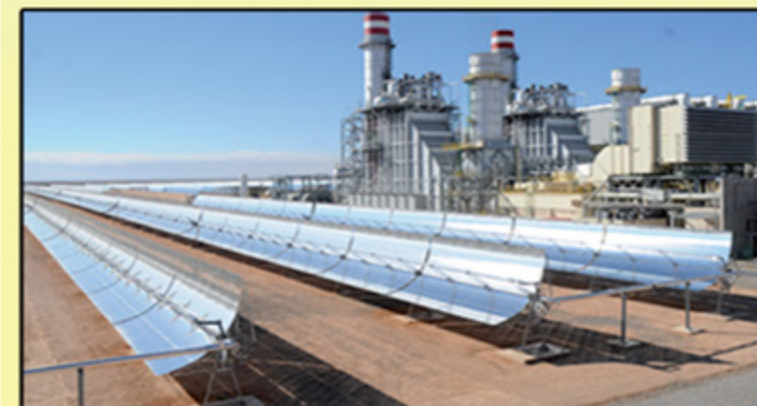
Centrale Thermo Solaire d'Ain Béni Mathar
