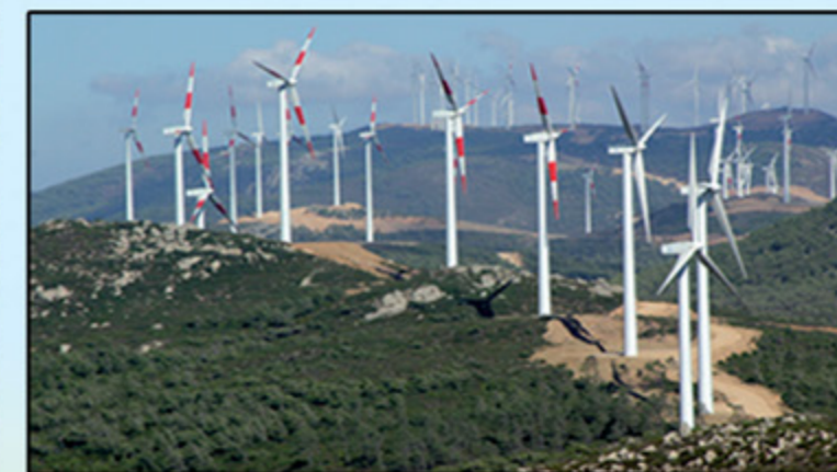
Parc Eolien de Tanger
